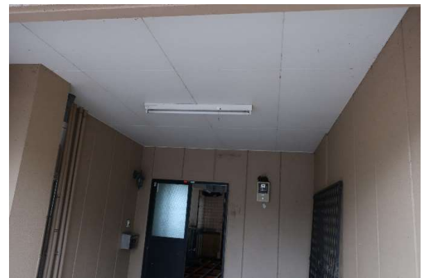
家屋内部 (天井近くまで浸水)
